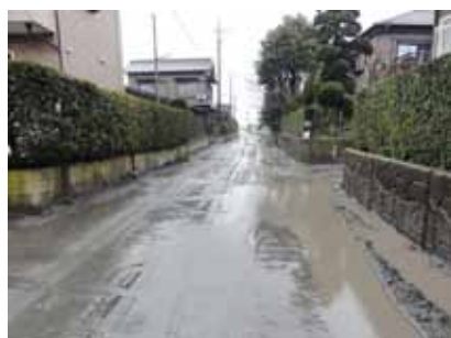
液状化で陥没した道路(稲敷市西代地区)
