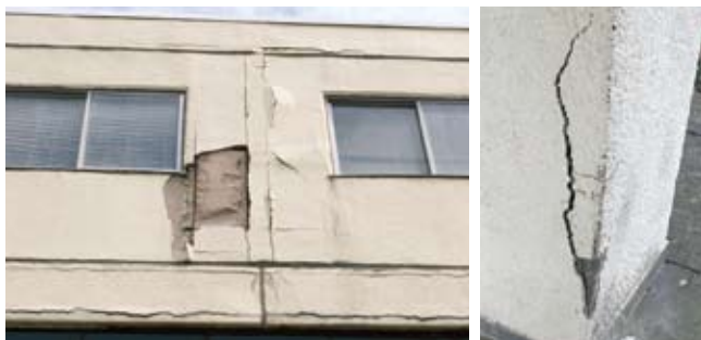
塩害で剥落したコンクリート外壁（左）。柱には大きな亀裂が（大島元町付近）
