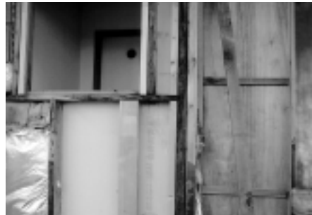
リフォーム前の 傷んだ外壁(上) と内部の柱
