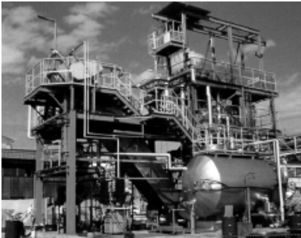
サーモバス実証試験設備 (JFEスチール(株)内)
