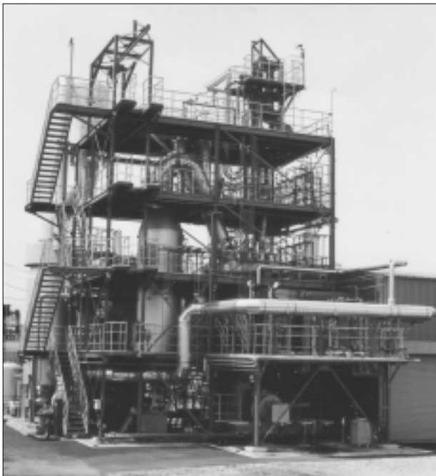
試験設備外観
