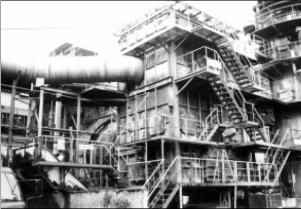
同和クリーンテックスの焼却設備
