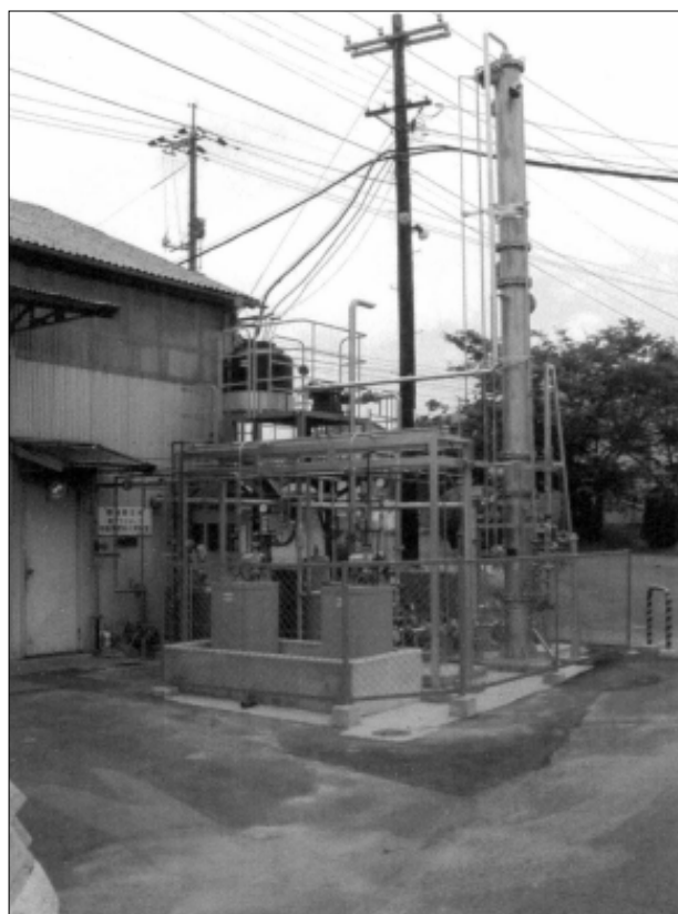
写真2 排ガス処理装置
