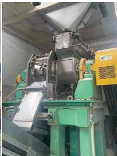
コンパウンド製造設備
